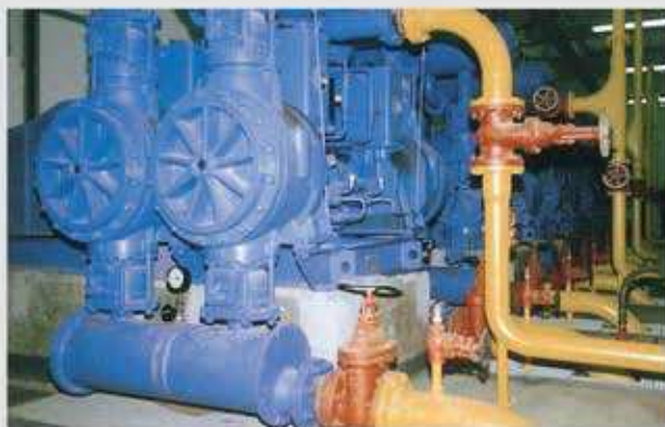
DG 50/130 - 2 K 250 - 4 SM 460 Q = 90 \text{ m}^3/\text{h} p = 16 \text{ bar} P = 55 \text{ kW} Среда: дигерированные шламы
