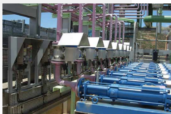
Разбавленные флокулянты Насосы 25I5, обеспечивающие расход в диапазоне от 2 до 6 м³/ч (добыча никеля)
