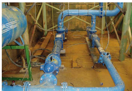
Подача на фильтр-пресс: один насос с высоким расходом и один насос высокого давления
